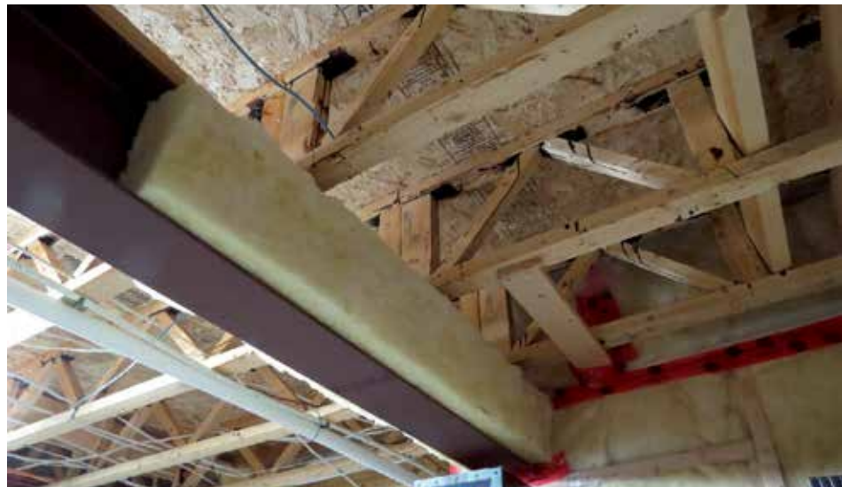
Cette poutre d'acier au sous-sol se poursuit dans un garage non chauffé. Pour minimiser l'effet de pont thermique, on l'a recouvert de laine isolante. PHOTO : André Dumont
